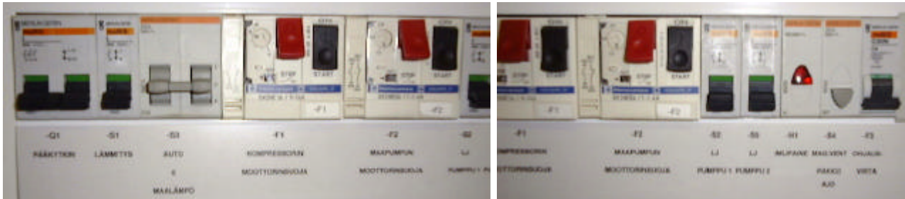
Kuva 14. Käyttökytkimet ja moottorinsuojakytkimet sekä merkkilamppu
